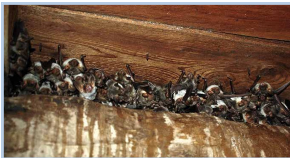
Figura 9 - I posatoi dei pipistrelli sono riconoscibili per le macchie di urina che impregnano le travi e la muratura, oltre che per le macchie scure di guano (da Casale F., 2016)
