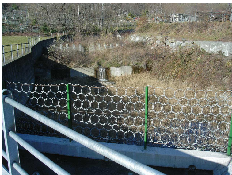
Fig. 19 – Rete paramassi posizionata nell'alveo del Rio Pisone con lo scopo di trattenere il materiale grossolano eventualmente trasportato dal corso d'acqua.
