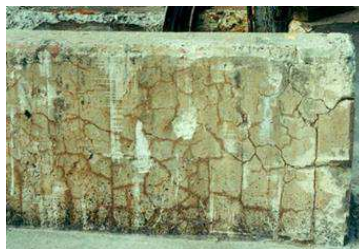
Exemple de détérioration du béton en raison de l'AAR
