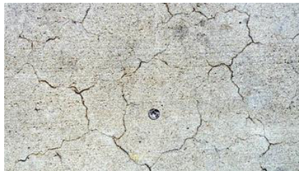
Exemple de fissuration précoce dans le béton: les dimensions des fissures sont comparées à celles d'une pièce de monnaie
