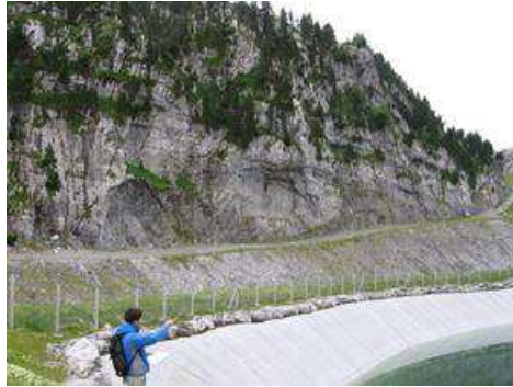
Barrage d'altitude soumis aux chutes de blocs
