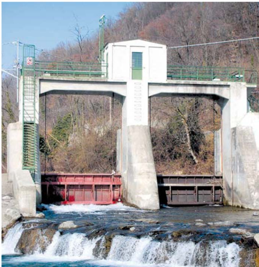
Sbarramento con paratoie piane
