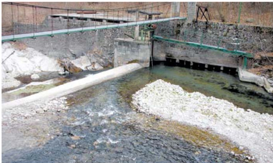
Traversa fissa con paratoia sghiaiatrice e bocca di presa multipla: si noti l'accumulo di detriti a monte dell'opera di sbarramento
