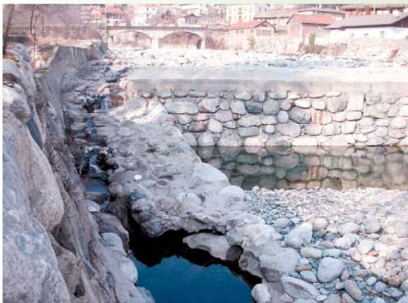
Rampa in pietrame in pessime condizioni, scalzata alla base e praticamente in asciutta
