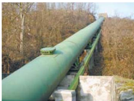
Condotta di derivazione in pressione a servizio di una stazione di pompaggio
