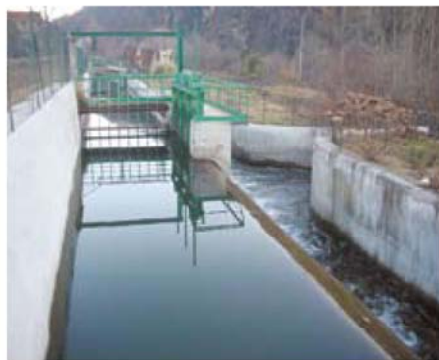
Rilascio da sfioratore di regolazione delle portate massime derivate posto lungo il sistema di canalizzazione dell'opera di presa
