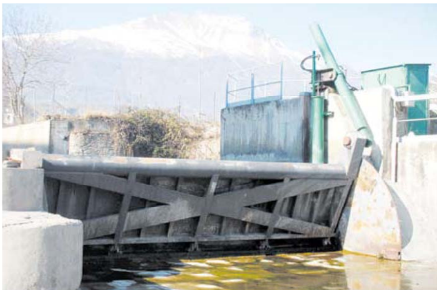
Paratoia a ventola vista da valle
