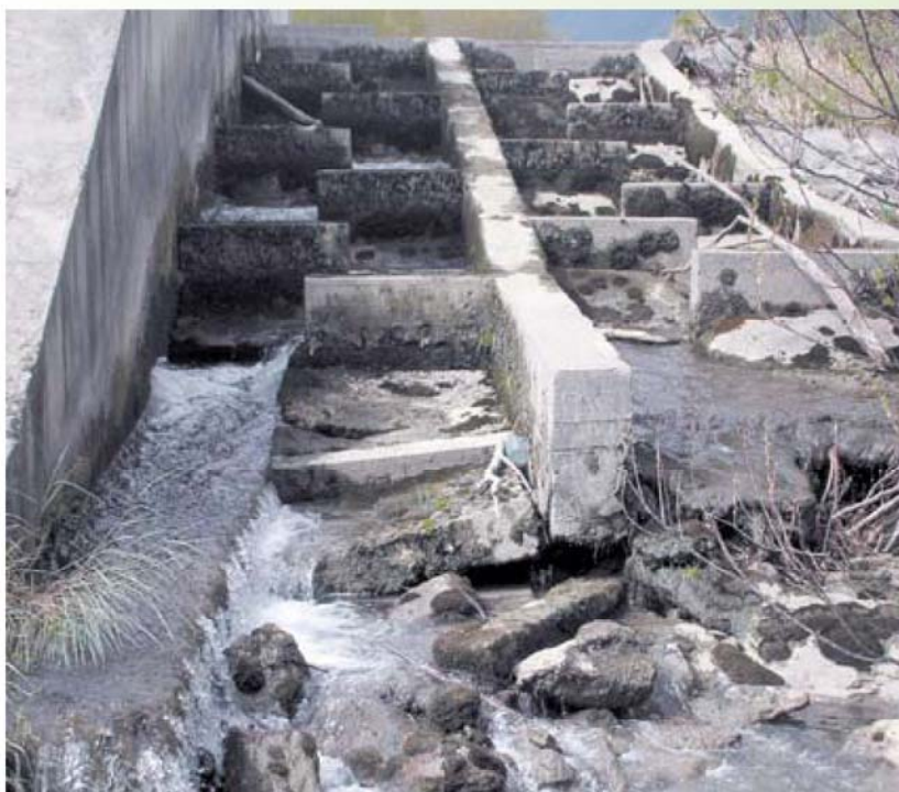
Passaggio a bacini successivi costituito da doppia rampa in parte asciutta e con marcati segni di dissesto strutturale
