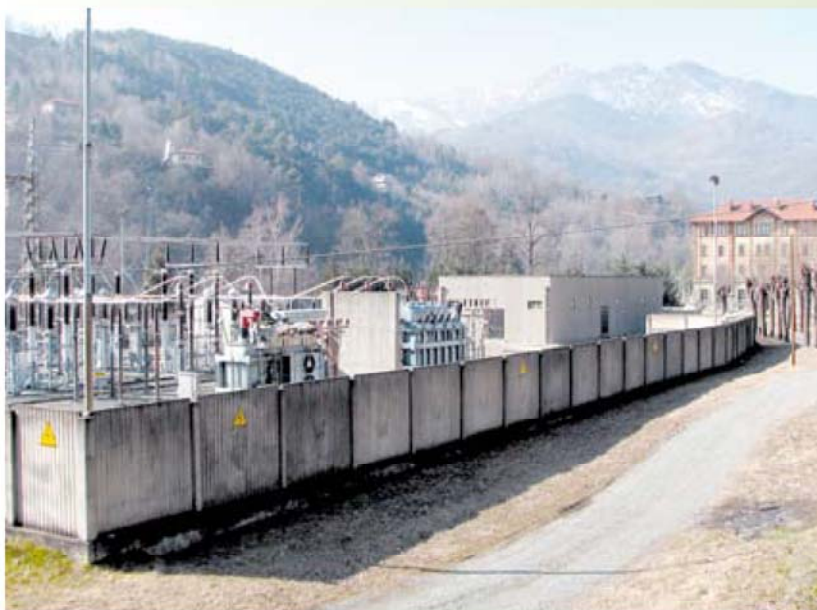
Centrale di produzione e centrale di trasformazione e smistamento
