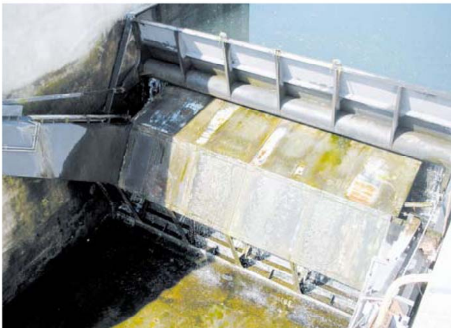
Paratoia mista caratterizzata da una paratoia a settore con sovrapposta una paratoia a ventola
