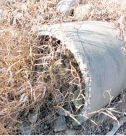
Manufatto di scarico abbandonato in alveo
