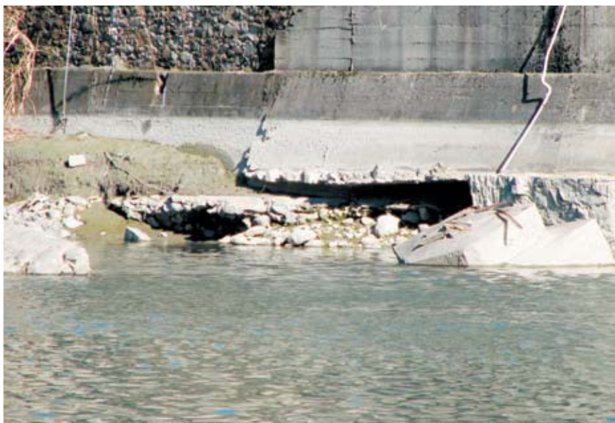
Opera soggetta a scalzamento
