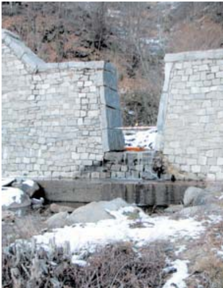
Alcune opere quali le briglie possono causare importanti interruzioni della continuità longitudinale
