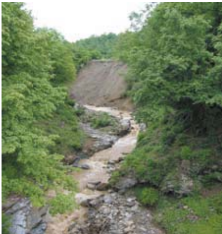
Effetto dell'erosione al piede della scarpata con conseguente smottamento
