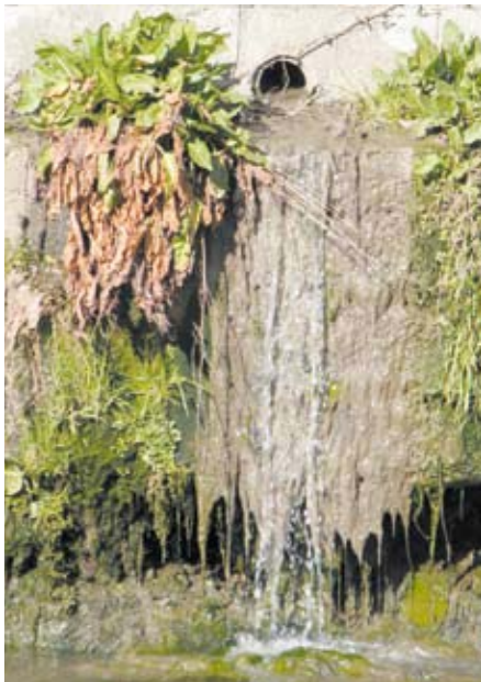
Esempio di scarico di acque reflue
