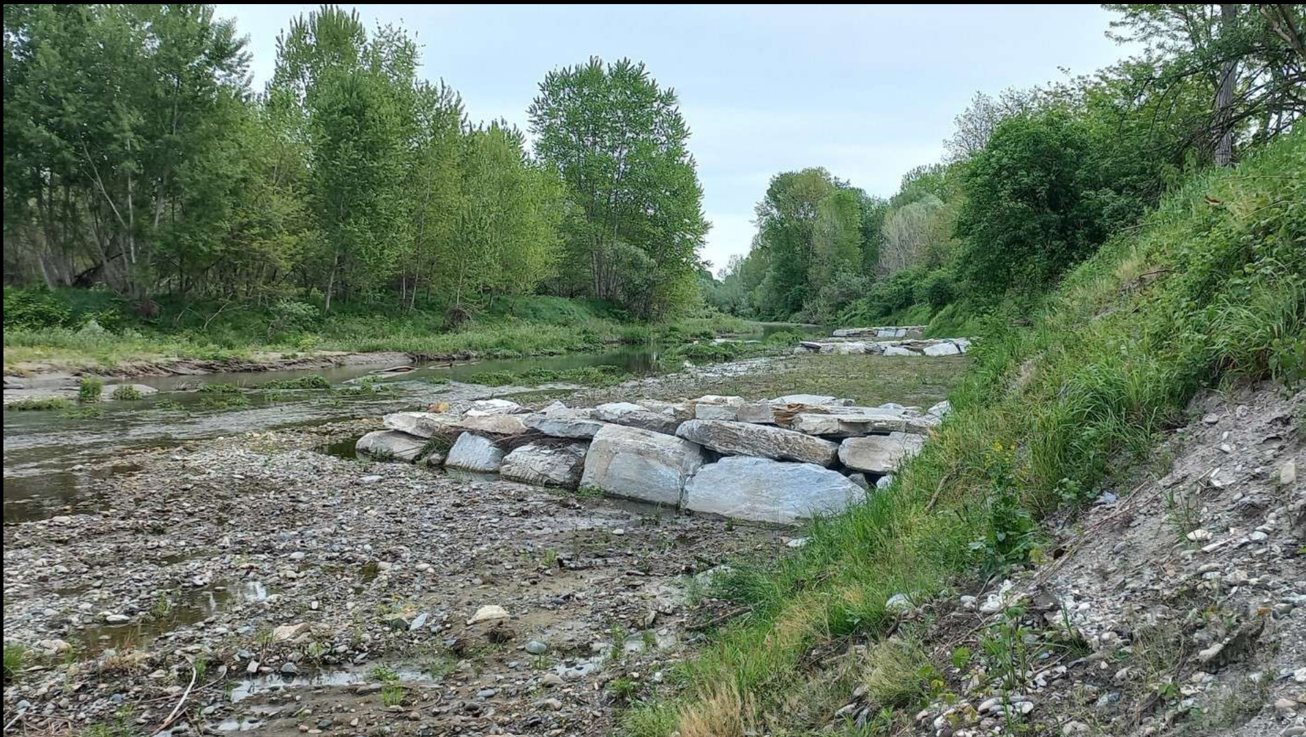
Vista verso valle della sponda destra con i pennelli in loc. Ruata.
