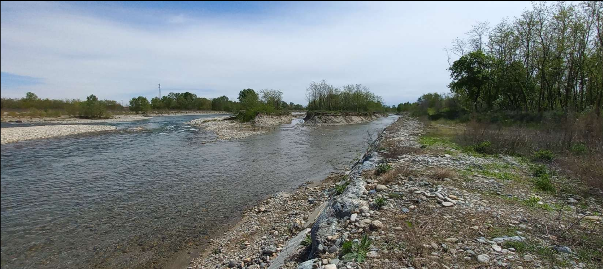
Vista da monte verso valle dei nuovi canali aperti sulla sponda destra del Pellice alla confluenza Chisone
